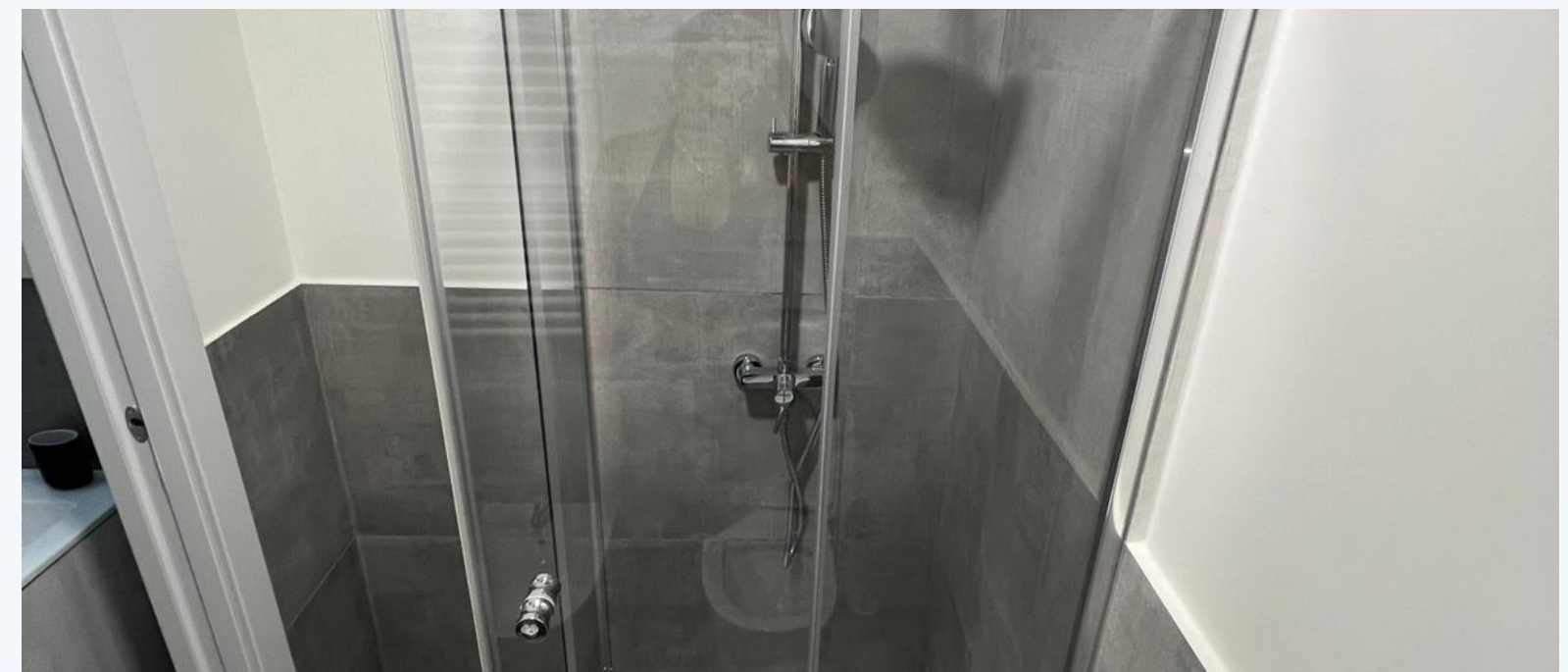
Dopo: box doccia riparato
