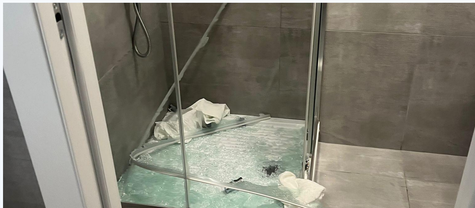
Prima: box doccia rotto
